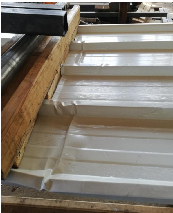
Фигура 9. Разрушен покривен панел с дебелина 100 mm
