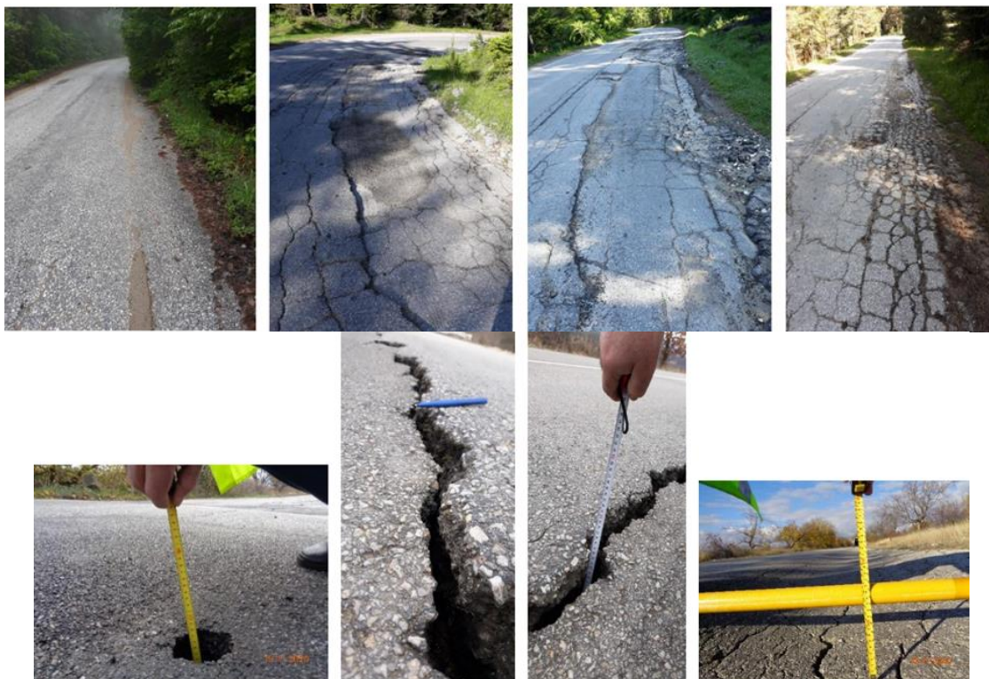
Фигура 1. Локални нарушения: надлъжни пукнатини и пропадане (фотография Ива Павлова)
